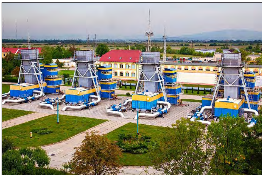
Компресорна станція «Ужгород»
